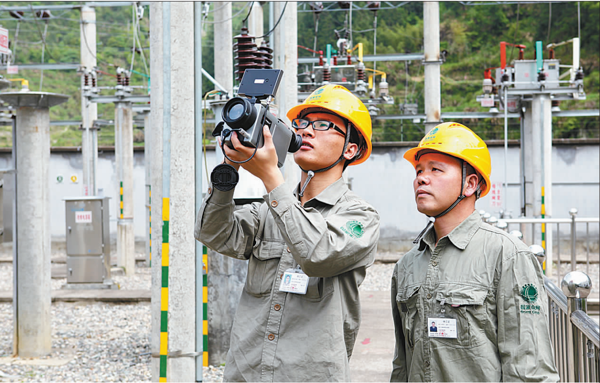
景宁供电公司运维检修部运维班职工正用红外线测温仪认真给设备测温。为扎实做好迎峰度夏和防汛工作期间的电网安全供电工作,该公司于近期对全县 10 座 35 千伏变电站设备加强了巡视。(通讯员 陈龙伟 摄)
