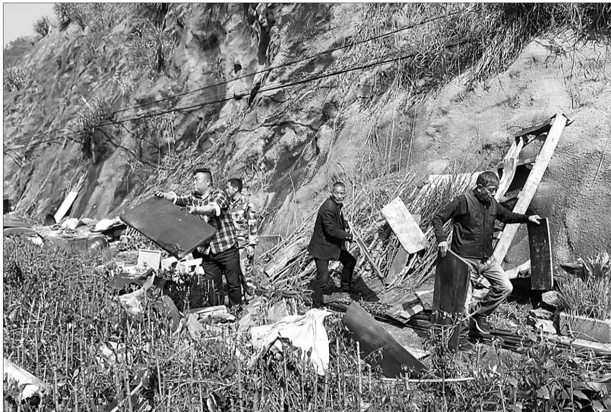
3月12日,县综合行政执法局和红星街道联合开展城乡环境整治提升行动。行动中,执法人员对红星街道岭北移民安置小区内的违章建筑、违规搭建、散养家禽家畜等问题进行集中整治。此次整治行动共拆除禽类棚舍40余个,清理点位60余处,拆除违建90余平方米,清运垃圾31车,助力城乡环境进一步提升。(通讯员 毛海君 柳二娟摄影报道)
